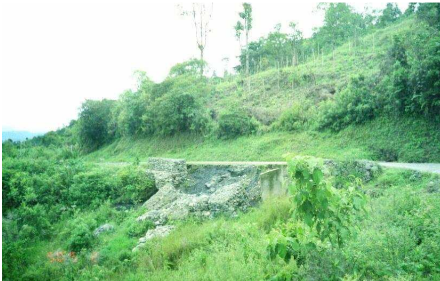
Hundimiento de la banca en la vía San Pedro – El Rincón
