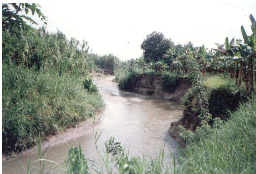
FOTO No. 34 Erosión marginal río Paila, área de protección del río intervenida aumentando el problema
